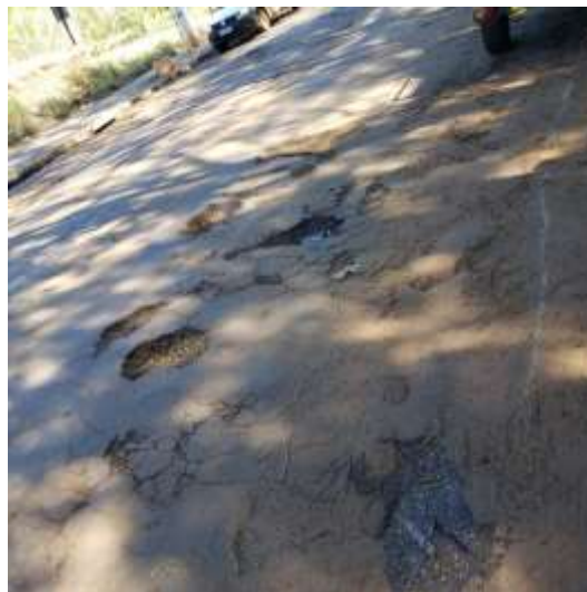
Figura 5: Inadequação do pavimento da via de acesso de Barbosa Ferraz Fonte: Autores
