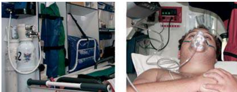
Fig. 43 Equipamento fixo para administração de oxigénio.
