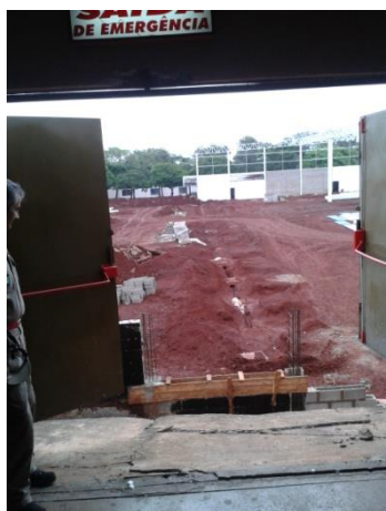
Figura 1 - Estabelecimento P saída de emergência inutilizada por escavação Lateral.
