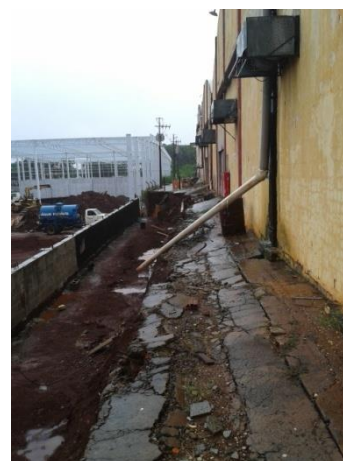
Figura 3 - Sistema de hidrante impossibilitado para teste na lateral do Estabelecimento P
