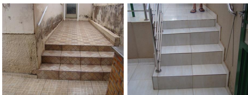
Figura 13 Presença de degraus locais das quedas (esq) na residência de D. e a (dir) residência de An.
