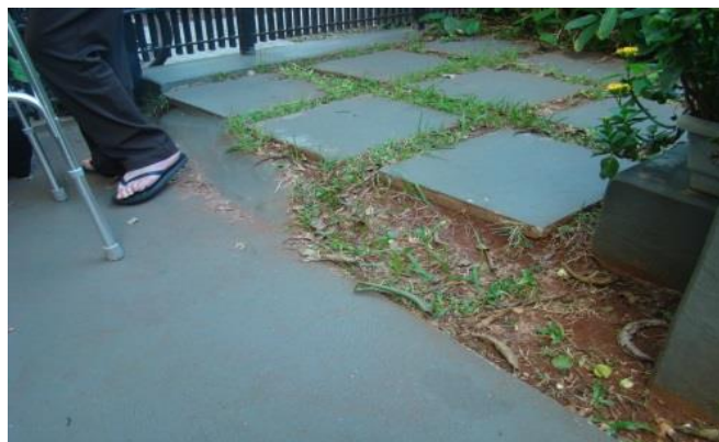
Figura 14 Rampa de acesso com desnível e diferença de piso residência En. Fonte: Acervo Pessoal.
