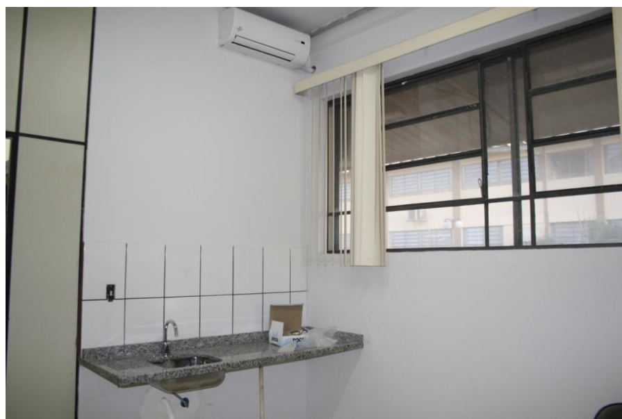
Figura 7: Após a colocação de pia com água quente. (Data 16.08.11).
